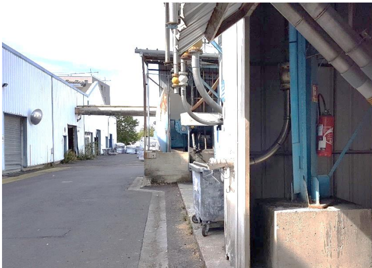
Cuve n°123 : Présence d'un extincteur poudre dans le local dépôtage silo
