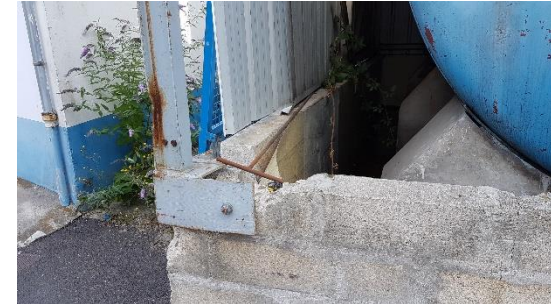
Dégradation de la rétention et étanchéité Cuve 123
