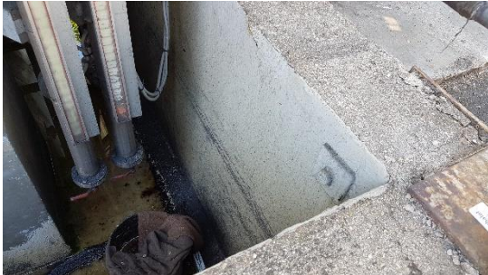
Résine appliquée à hauteur de rétention Cuve 123
