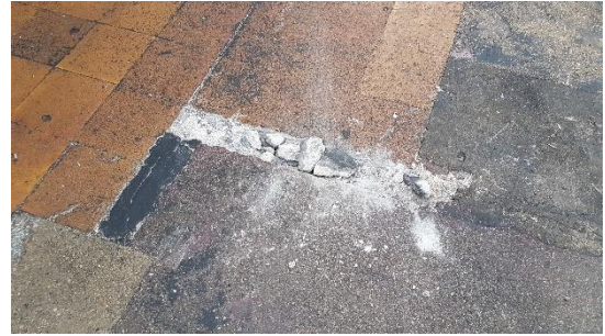
Altération du sol
