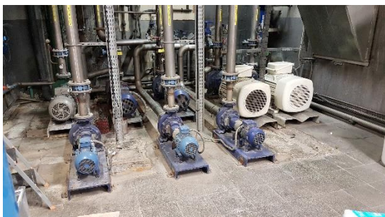
Zone d'installation des pompes
