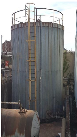
Cuve fioul lourd
