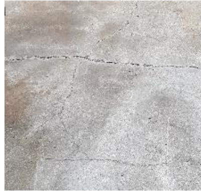
Fissuration des sols
