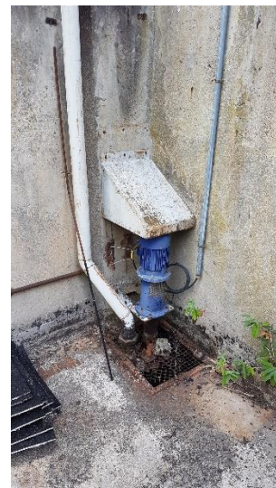
Pompe de relevage Hors Service
